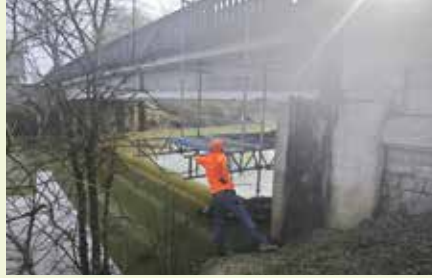
D708 - Travaux de renforcement et réhabilitation du pont de Banarge sur le Dropt, financés par le Département à hauteur de 635 000 €.
