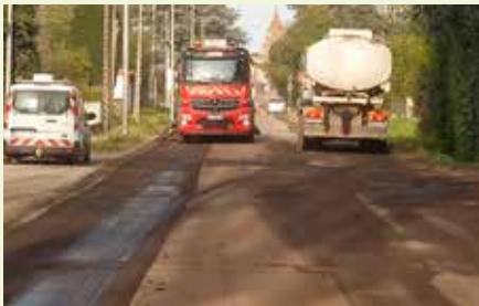
D911L - Travaux de réfection de la couche de roulement, financés par le Département à hauteur de 500 000 €.
