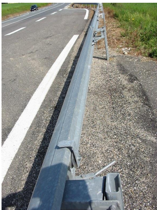
Accotement sous glissières stabilisé au premier plan (à encourager) et sulfaté au deuxième plan (interdit : photo de 2011)
